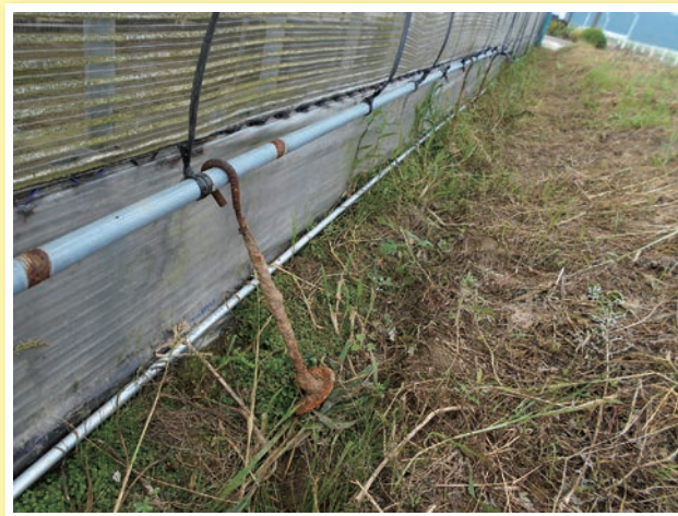
大風によって引抜けたアンカー
