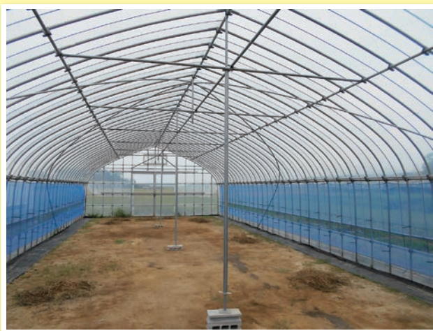
雪対策として設置された柱
